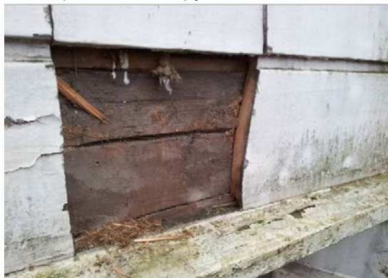
Рисунок 5. Демонстрация плохого состояния деревянных стеновых материалов
