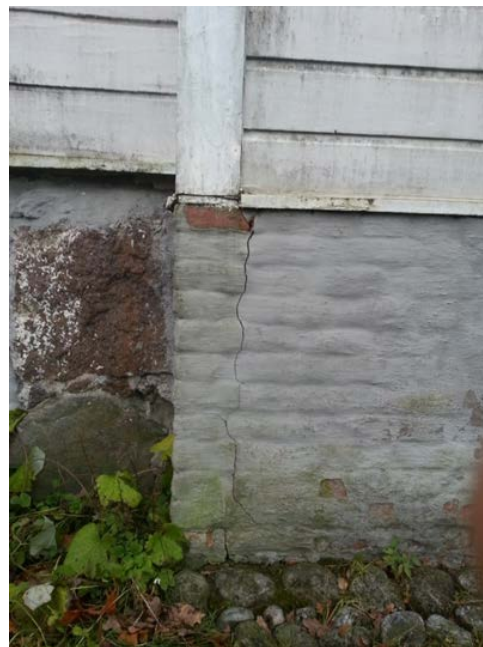
Рисунок 2. Трещины в фундаменте
