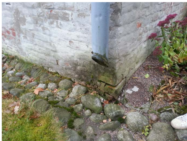
Рисунок 3. Повреждения фундамента водой
