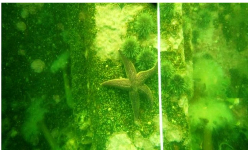
Рисунок 2. Вид стального шпунта «Ларсен» V, пораженного коррозией
