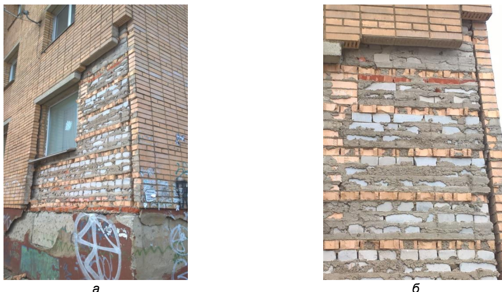
Рисунок 3. Обрушение фрагмента лицевой кирпичной кладки наружных стен жилого здания в Смоленске: а — общий вид; б — фрагмент фасада
