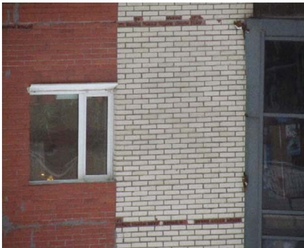
Рис.2 Деструкция в области сопряжения с плитой перекрытия и в углах оконных проемов
