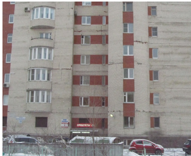
Рис.3. Пример здания с повреждениями облицовочной кирпичной кладки из пустотелого кирпича
