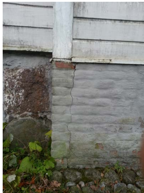
Рисунок 2. Трещины в фундаменте
