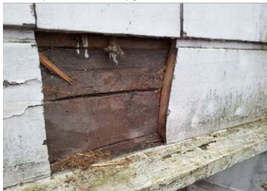
Рисунок 5. Демонстрация плохого состояния деревянных стеновых материалов
