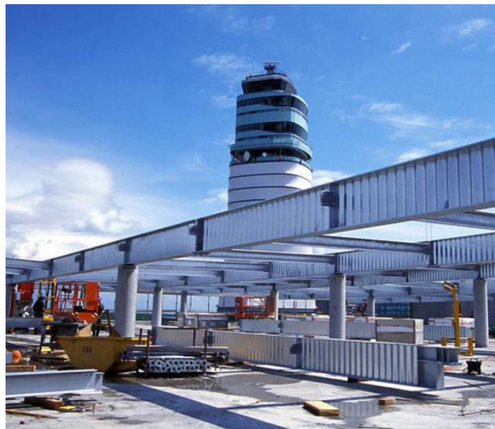
Рисунок 6. Многоэтажная автостоянка в аэропорту города Вена, Австрия. В качестве балок перекрытия применены стальные балки с волнисто-гофрированной стенкой производства компании Zeman. [6]
