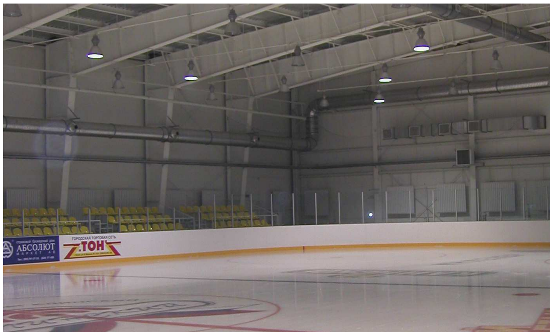
Рисунок 7. Приточный воздуховод с сопловыми насадками для подачи воздуха наклонной струей в зону ледовой площадки
