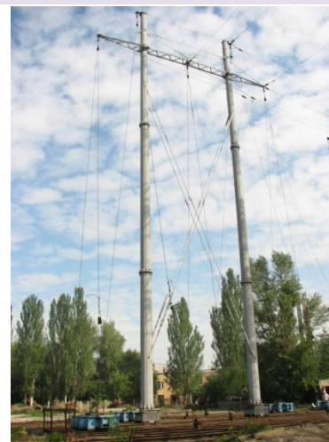
х) Промежуточная металлическая опора на основе МГС для Крыма
