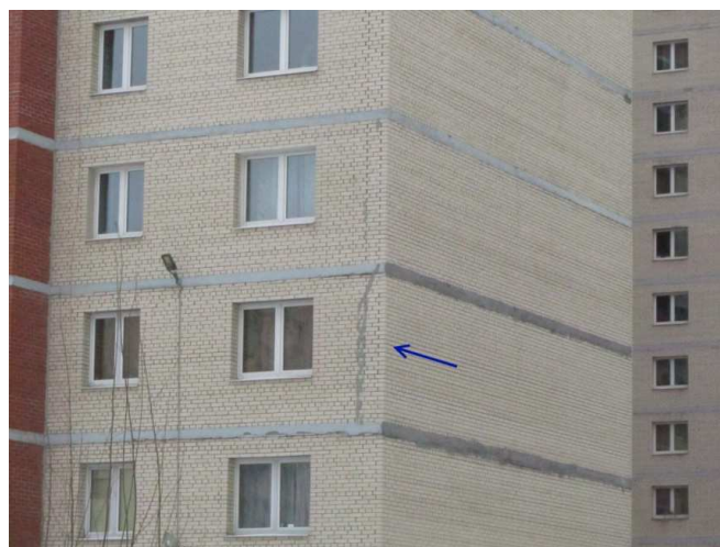
Рисунок 2. Вертикальная трещина, вызванная деформациями растяжения торцевой стены
