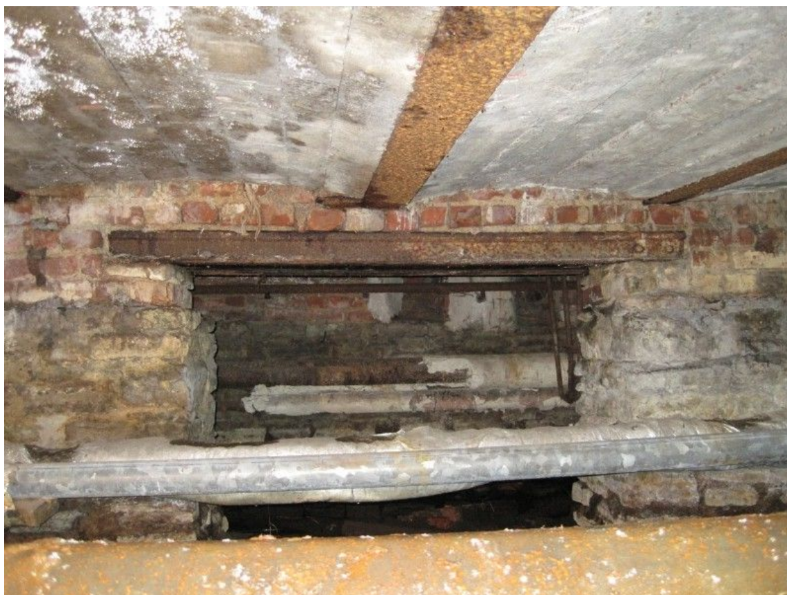
Рисунок 7. Обильное замокание бетонных сводов перекрытия
