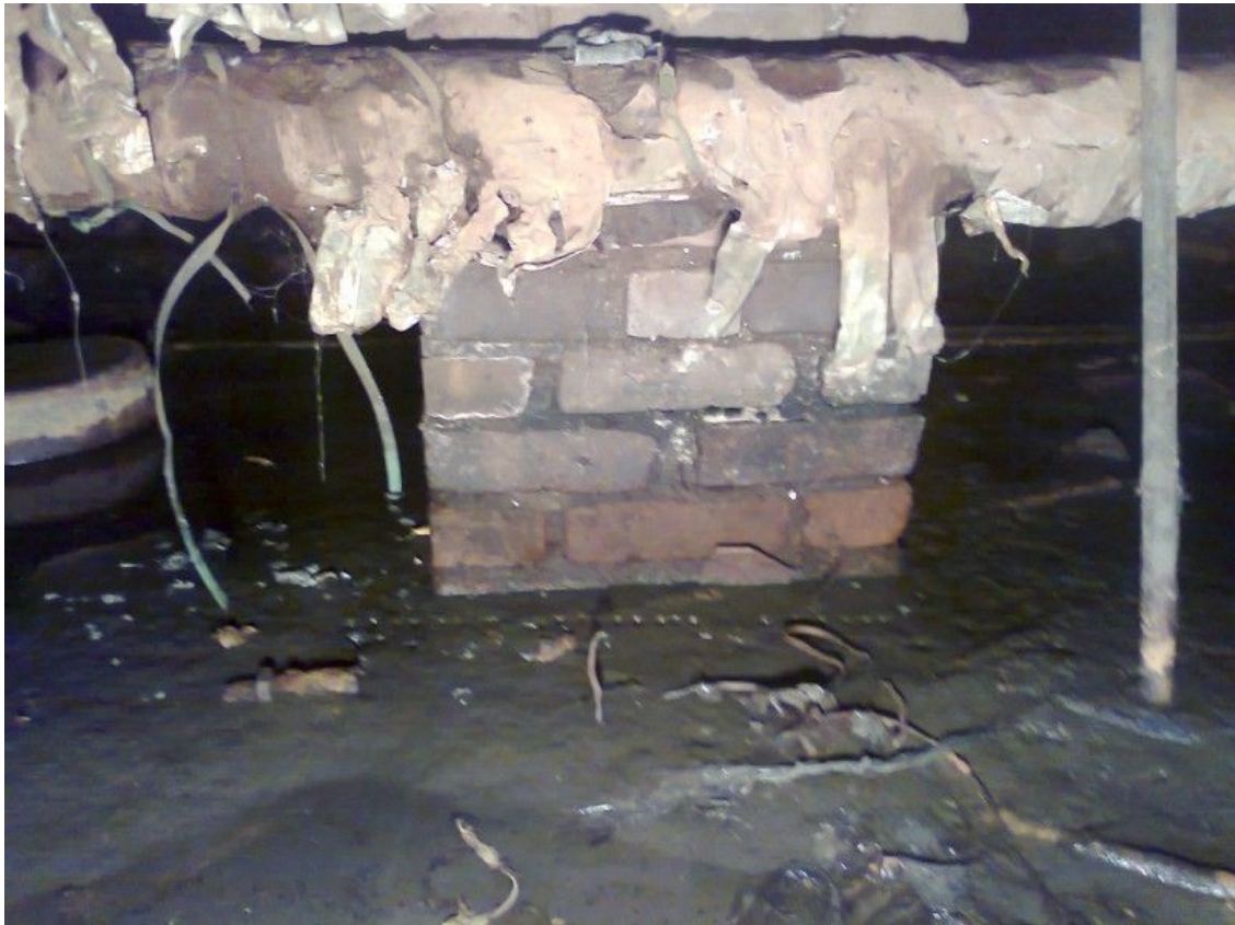
Рисунок 8. Разрушение швов кладки кирпичных столбов
