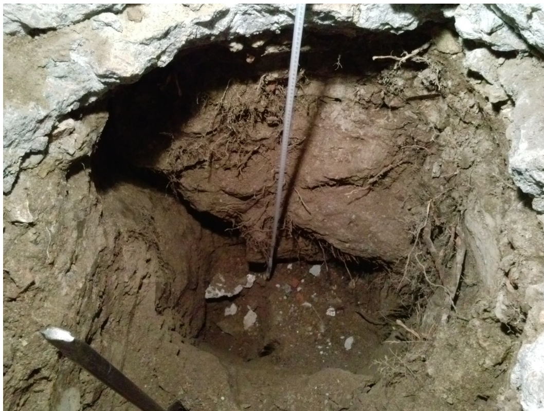
Рисунок 4. Поражение тела бутового фундамента корневой системой растений
