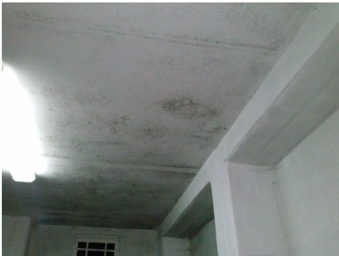
Рисунок 10. Плесень на перекрытии в подвальном помещении
