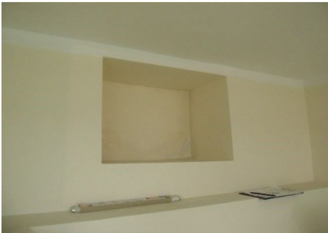
Рисунок 1. Заложенный продох в подвальном помещении
