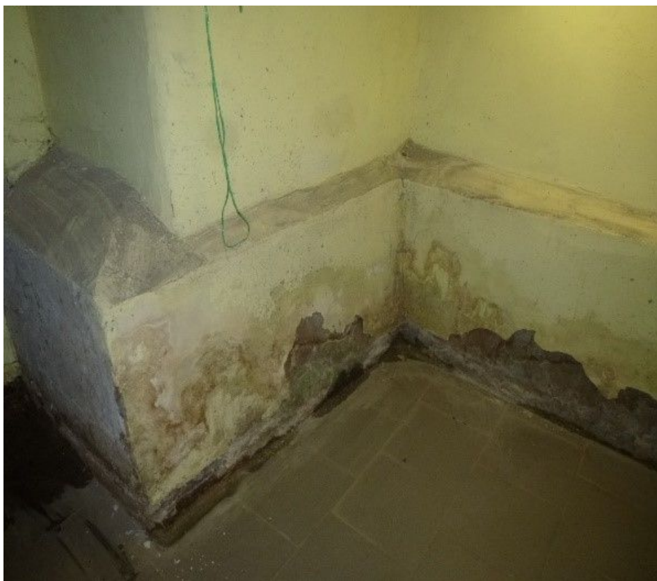
Рисунок 3. Замокание кладки стены подвала в связи с капиллярным поднятием влаги
