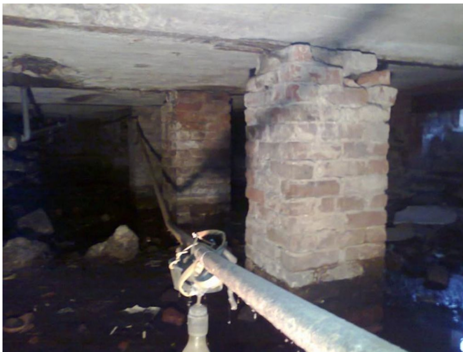
Рисунок 5. Подтопление подвального помещения
