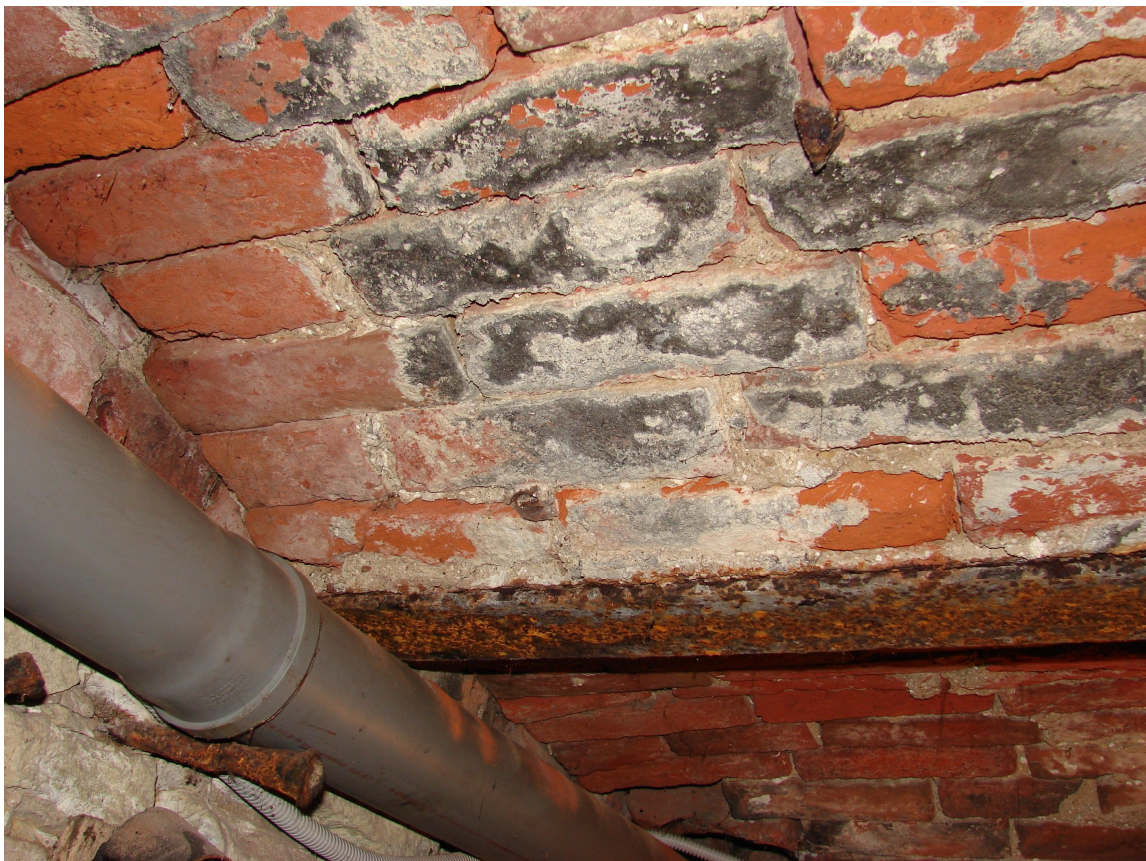
Рисунок 9. Биопоражение сводчатого перекрытия подвала
