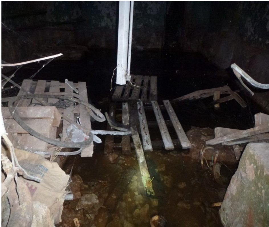
Рисунок 2. Затопление подвального помещения
