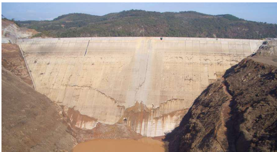
Рисунок.1. Трещины в железобетонном экране плотины Campos Novos (вид с верхнего бьефа)
