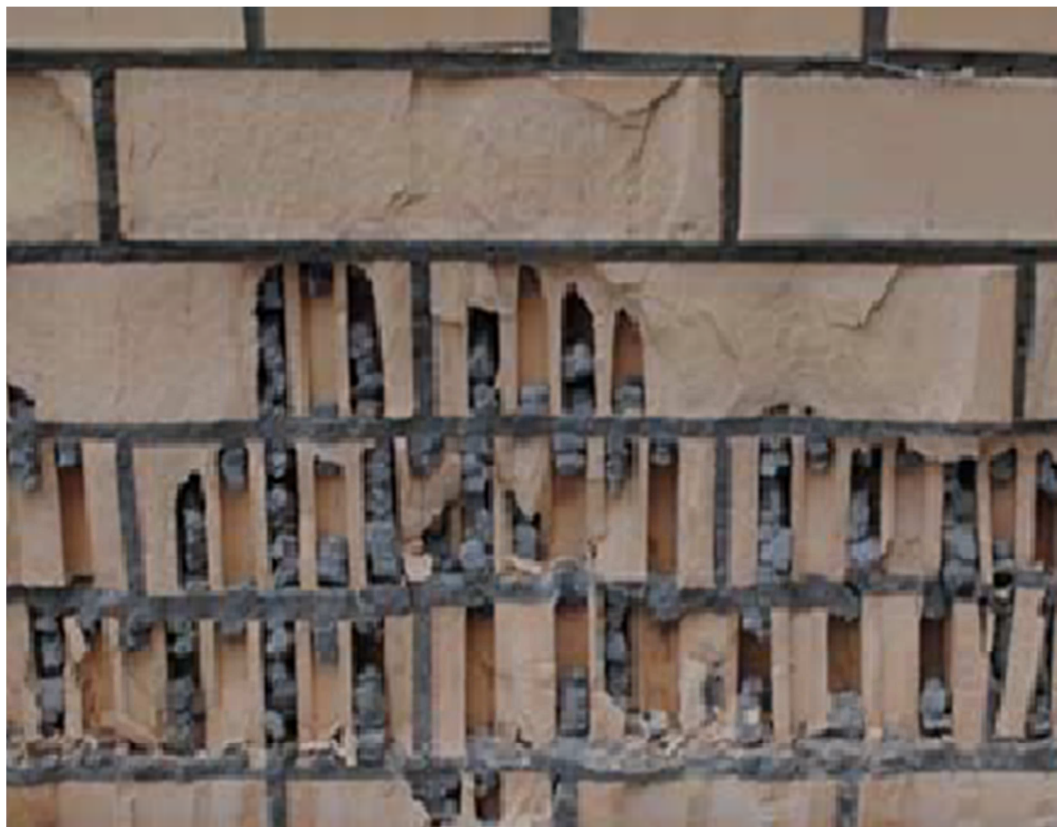
Рисунок 15. Частичное заполнение раствором пустот в облицовочном каменном слое
