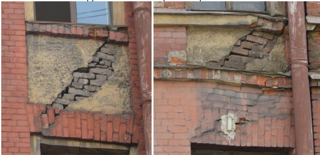
Рис. 6 - Фрагменты несущей стены здания 23 по улице Тележная. Трещины в перемычке и межоконном поясе раскрытием до 80 мм с вывалом раствора из швов, расслоением и смещением кладки, включая перемычку, с образованием конуса вывала.
