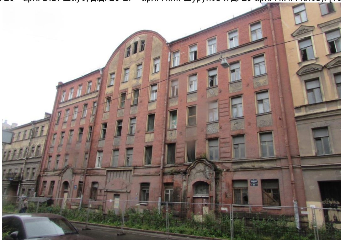
Рис. 1 - Фасад аварийного дома 23 по Тележной улице
