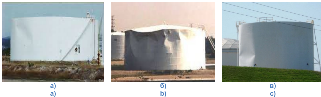
Рис. 2 – Потеря устойчивости стенки резервуара под действием ветра и вакуума Fig. 2 – Buckling of the tank wall under the of wind and vacuum action
