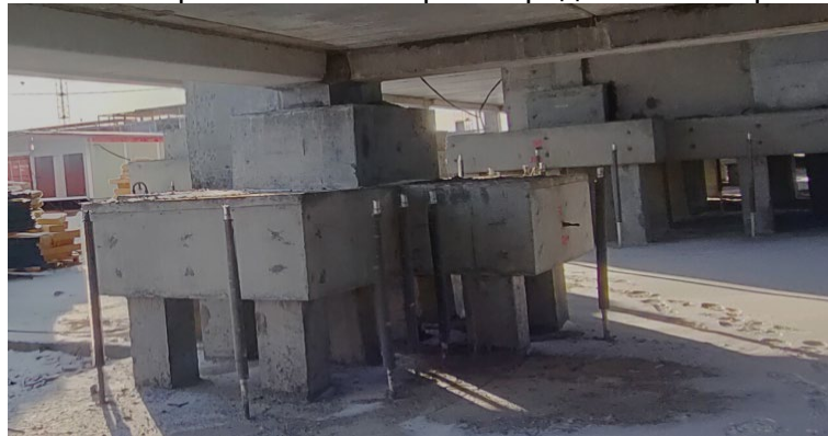
Рис. 1 – Общий вид конструкций фундаментов с термостабилизаторами Изображение выполнено автором статьи Fig. 1 – General view of foundation structures with thermal stabilizers Image by the author of the article
