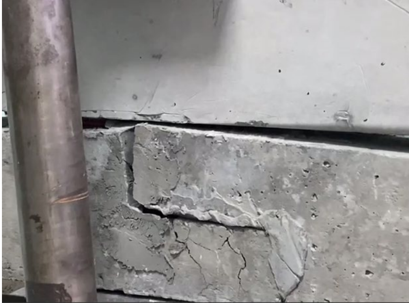
Рис. 9 - Разрушение составной балки по стыку Fig. 9 - Destruction of a composite beam at a joint Image by the author of the article
